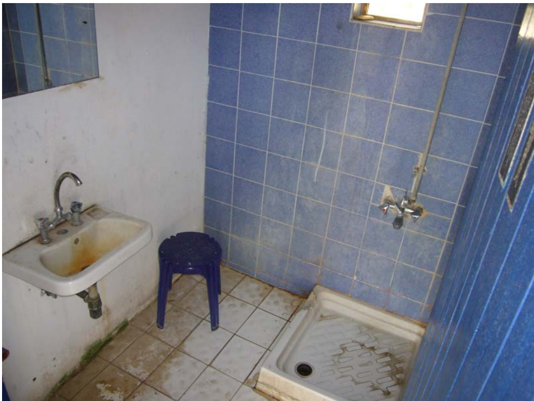
Marina Methana (N37°34,7 / E023°23,3) Sanitäre Einrichtung
